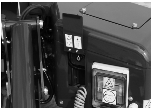
Fig. 131 Elektrisk boks indvendigt i rummet med elektriske komponenter.
