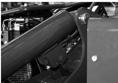
Fig. 11 Afbryderventil i sikkerhedsstiver
